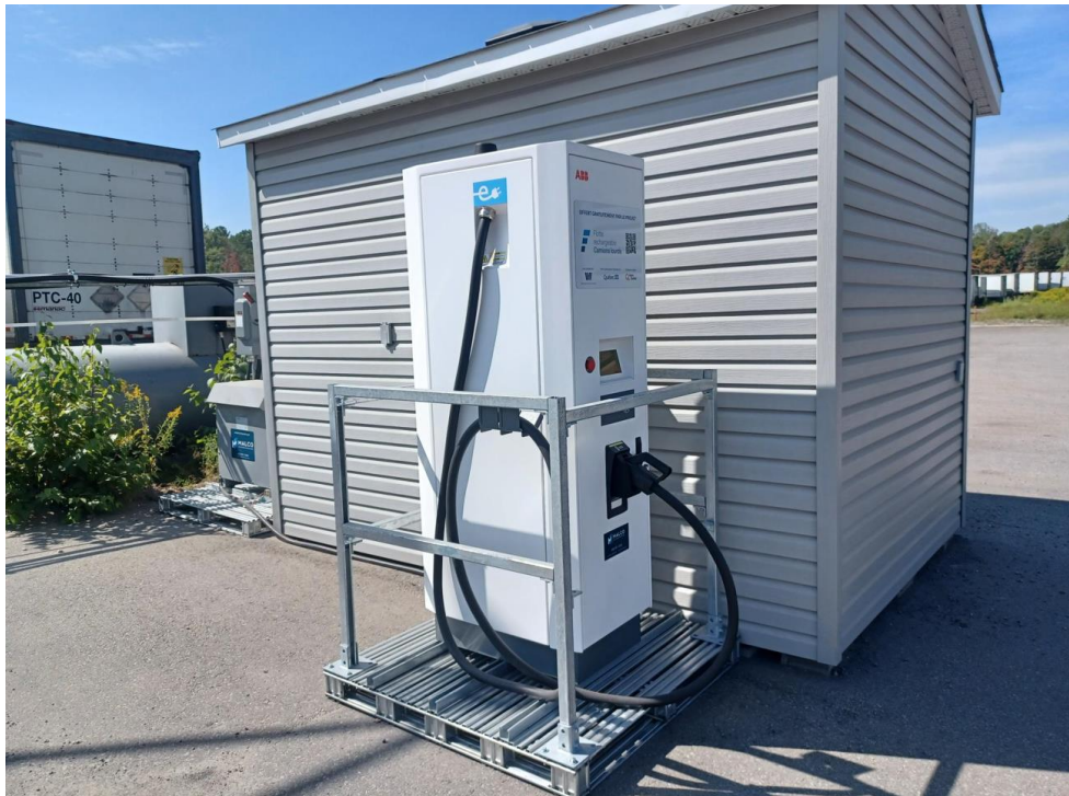
Figure 4 : Borne de recharge ABB Terra 54 HV et son transformateur, installés chez Inter-Nord
