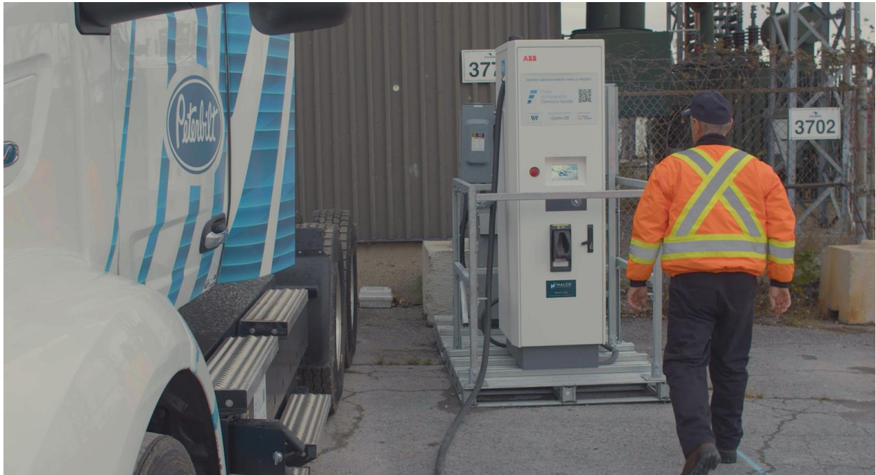
Figure 3 : Borne de recharge ABB Terra 54 HV et son transformateur, installés chez Cascades Transport
