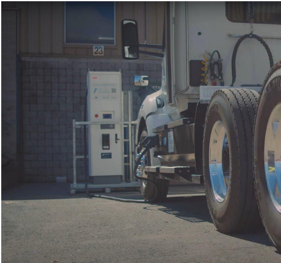
Figure 3 : Borne de recharge ABB Terra 54 HV installée temporairement chez Les Brasseries Sleeman
